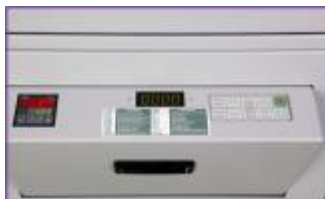
Sistema de Control Inteligente
